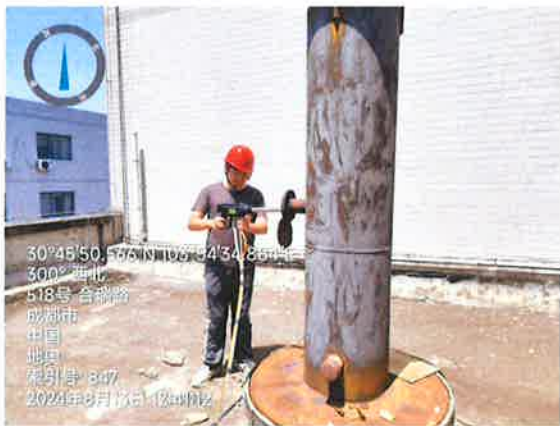
2#锅炉烟囱 (DA004)
