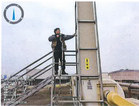
2#实验室废气排气筒（DA002）
