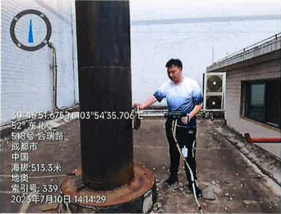
1#锅炉烟囱（DA003）
