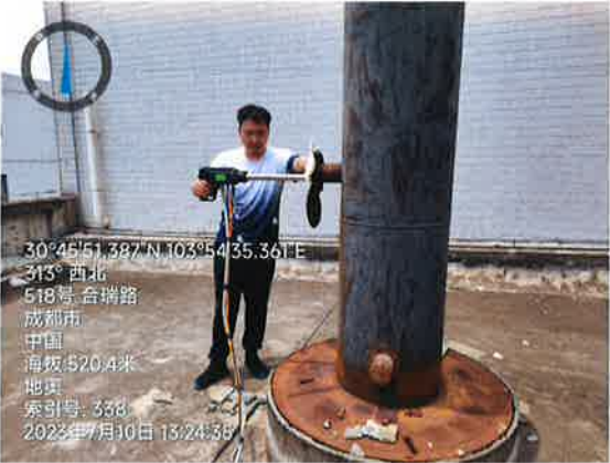
2#锅炉烟囱（DA004）
